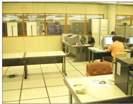
写真 2 スーパー・コンピューター室
