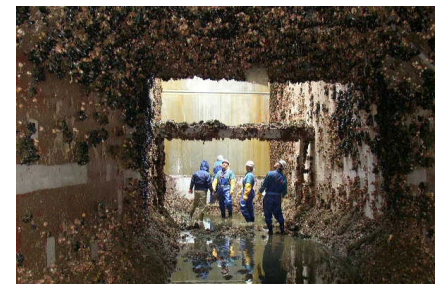
図1 付着生物で機能低下した発電所の海水導入管
