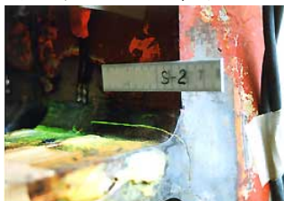
図 鋼構造物に生じた疲労き裂の例 (写真提供: 首都高速道路株式会社)
