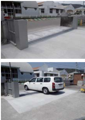
図1 徳島県日和佐港への設置 (上:設置完了、下:車両走行確認)
