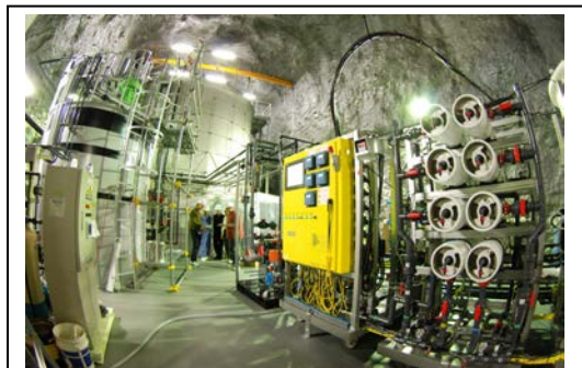
EGADS 実験施設の写真。左が 15 m 3 溶解槽、奥が 200 m 3 タンク、右が循環装置。
